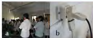
Figura 2 a y b: uso incorrecto de zapatillas y adaptadores.
