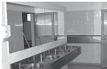
Figura 34. Instalaciones de un baño para manipuladores en una industria láctea
